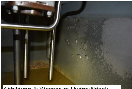
Abbildung 4: Wasser im Hydrauliktank. Stark gealtertes Hydrauliköl.
