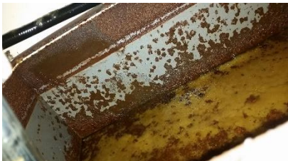
Abbildung 4: Wasser im Hydrauliktank. Stark gealtertes Hydrauliköl.
