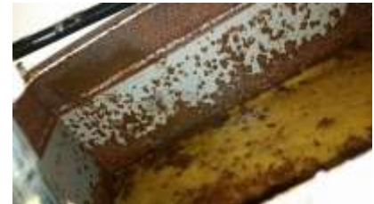
Abbildung 3: Wasser im Hydrauliktank. Stark gealtertes Hydrauliköl.
